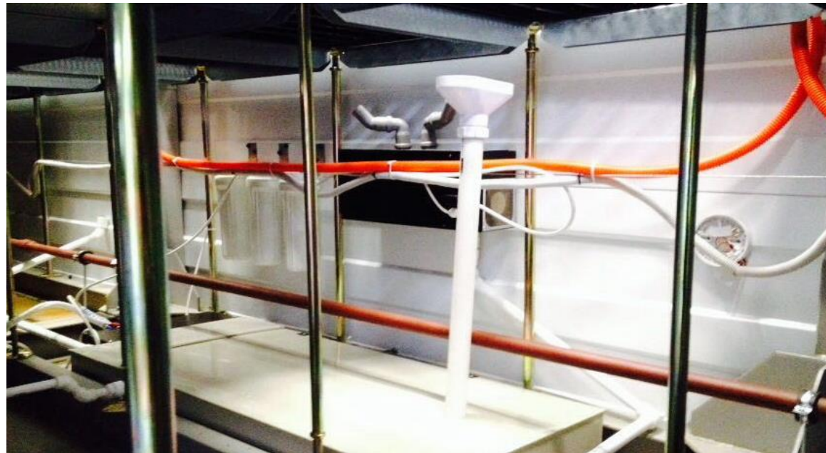
Размещение системы увлажнения под фальшполом
