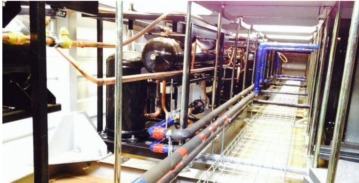
Размещение под фальшполом под стойками с ИТ-оборудованием
