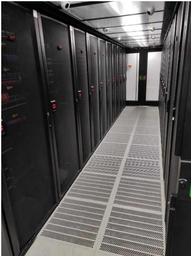
Система размещения оборудования в МЦОД
