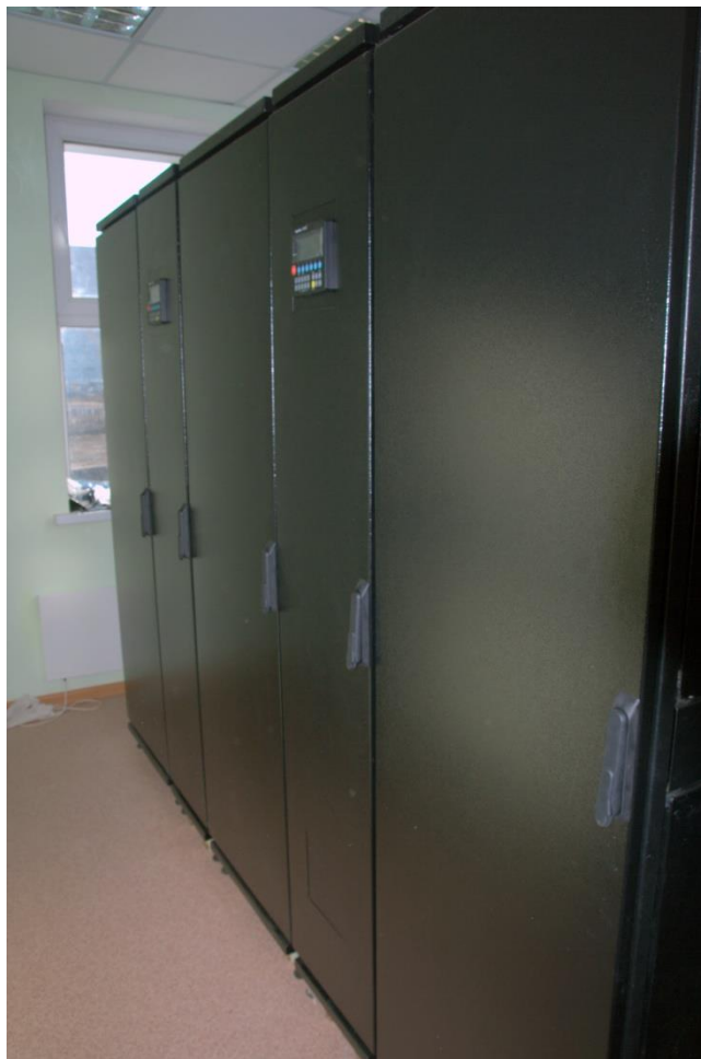
В неподготовленном помещении (склад, техническое помещение)
