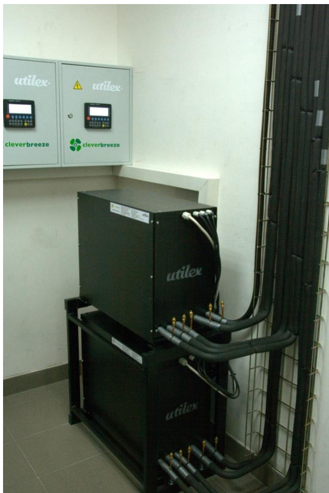
Компрессорные блоки и блоки управления
