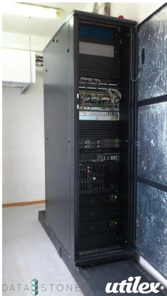
В помещении ИТ-отдела
