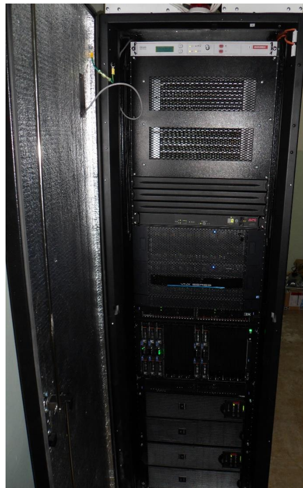
В неподготовленном помещении (склад, техническое помещение)
