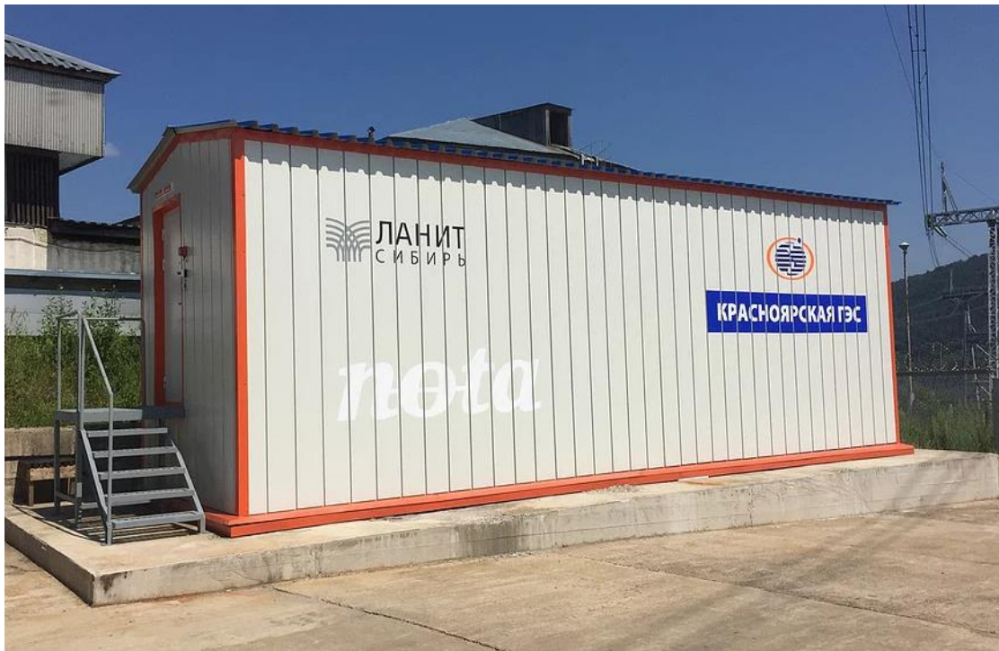
МЦОД для Красноярской ГЭС
