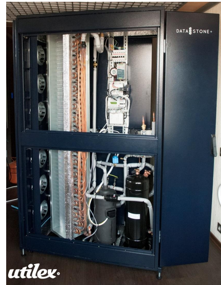
В помещении ИТ-отдела (со снятыми боковыми стенками)
